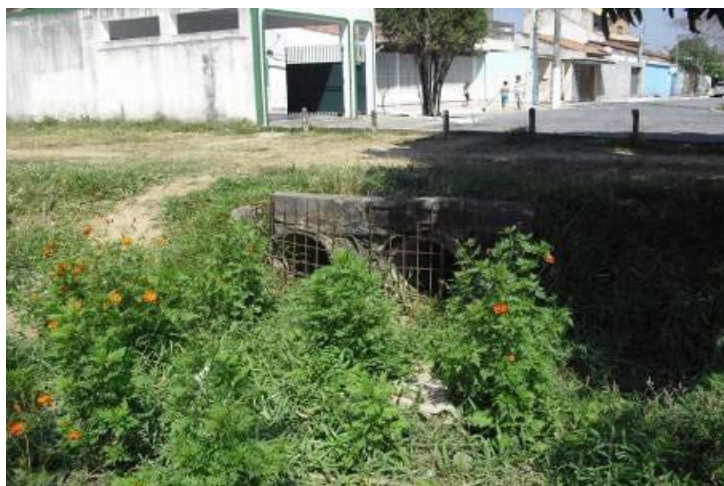
Figura 7: Tubulação de Coleta e Transporte da Água Pluvial – passa sob a Rua José Amilcar.
