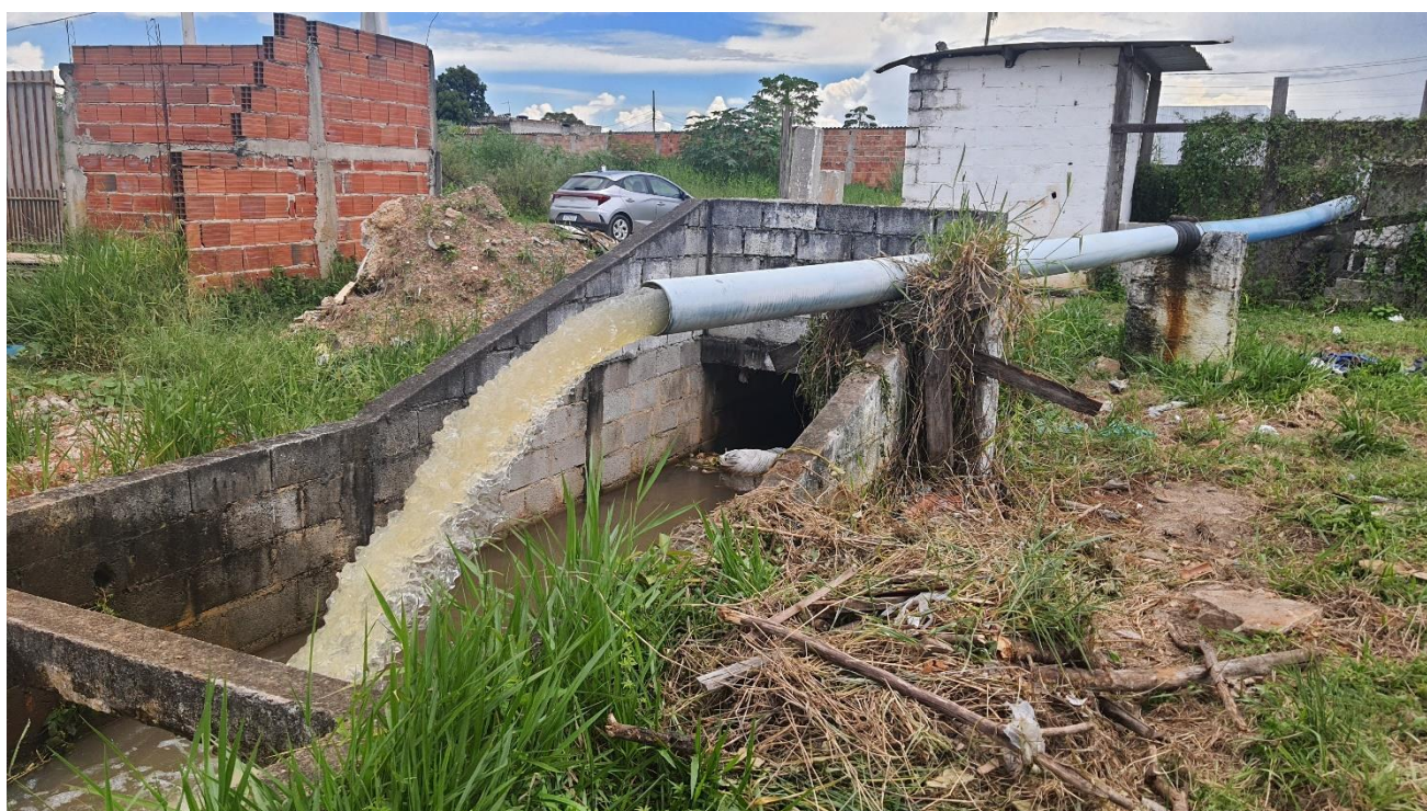
Figura 4: Transposição para o Rio Paraíba do Sul, por meio de canal na rua 8 - Região das Chácaras Agrícolas
