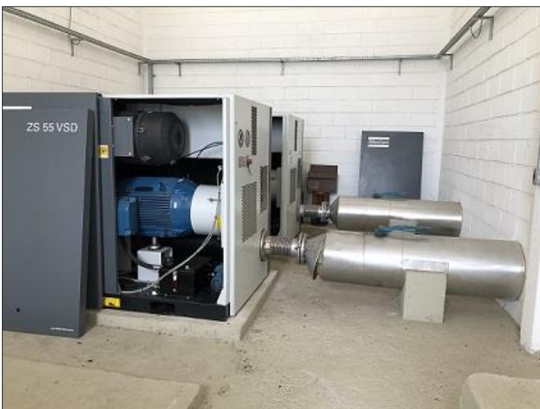
Foto C.13 - Detalhe dos Sopradores de Ar, da Atlas Copco.
