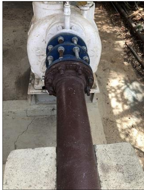
Foto A.5 - Barrilete da Bomba de 90m 3 /h.
