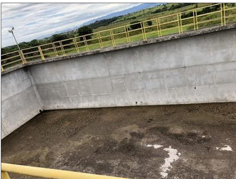
Foto C.10 - Tanque de Aeração.
