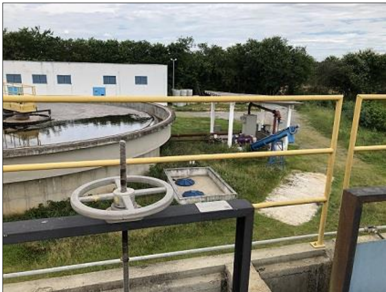
Foto C.15 - Detalhe da Prensa Parafuso para Desidratação do Lodo.
