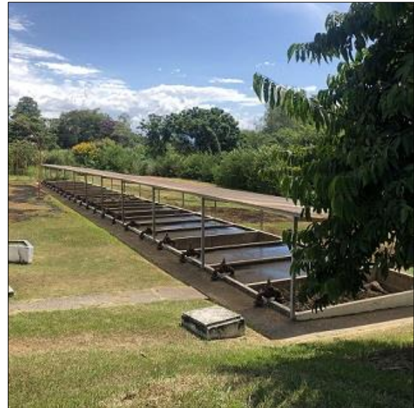
Foto B.11 - Leitos de Secagem de Lodo.
