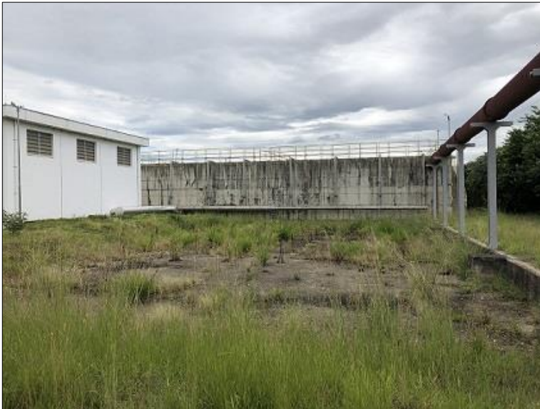
Foto C.8 - Detalhe dos Suportes em Perfis Metálicos da Tubulação para o Sistema de Tratamento.
