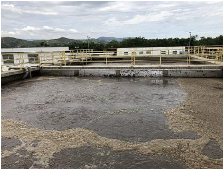
Foto C.11 - Tanque de Aeração.
