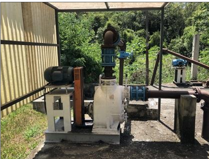
Foto B.4 - Barrilete da Estação Elevatória Final.
