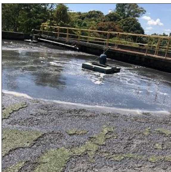
Foto B.8 - Tanque de Aeração.
