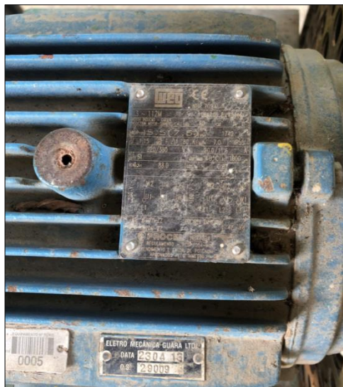
Foto A.6 - Motor (7,5cv) - Bomba de 54m 3 /h.
