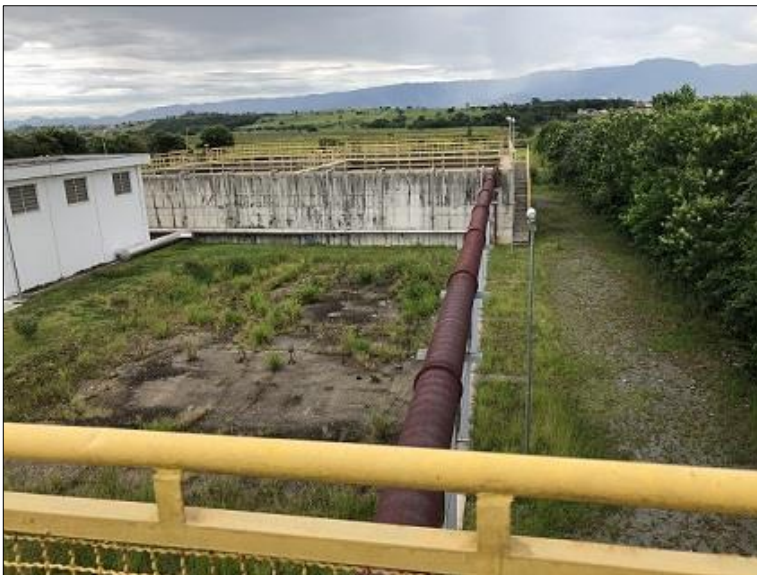
Foto C.9 - Tubulação para o Sistema de Tratamento.
