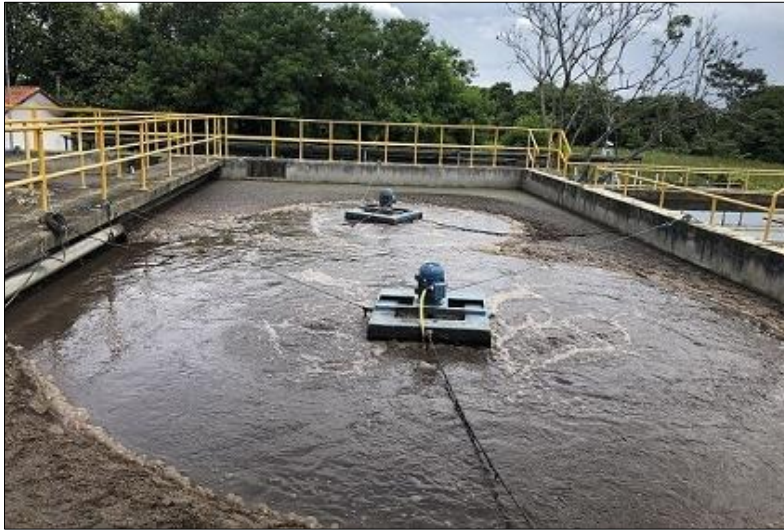
Foto A.10 - Tanque de Aeração.
