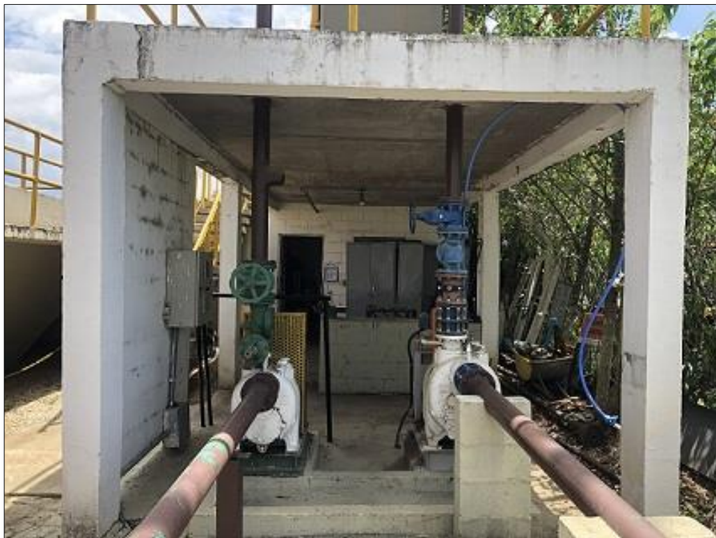
Foto A.3 - Estação Elevatória Final.
