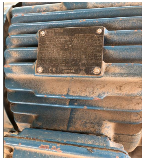
Foto A.7 - Motor (10cv) - Bomba de 90m 3 /h.
