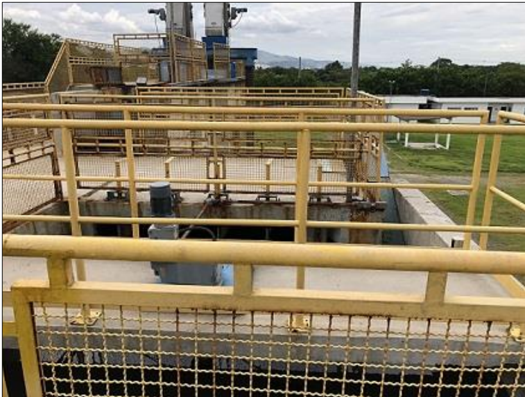
Foto C.2 - Vista do Tratamento Preliminar.
