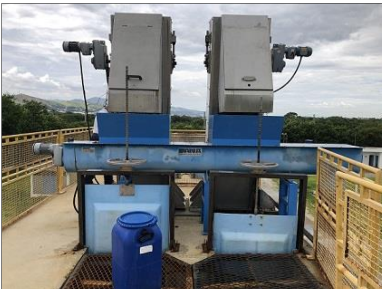
Foto C.3 - Tratamento Preliminar (Caixa de Areia Mecânica).
