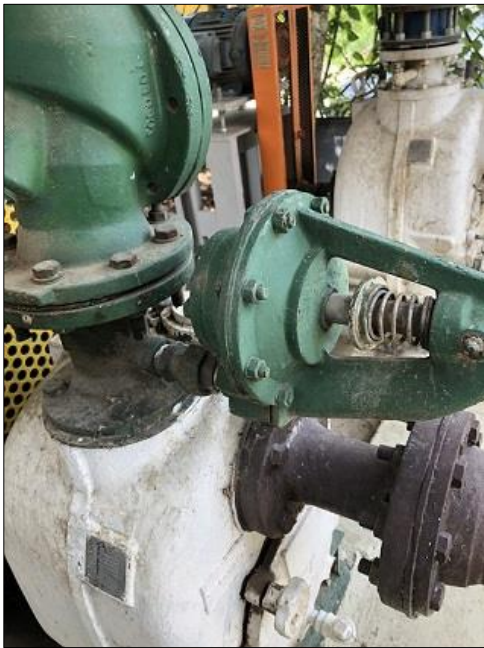
Foto A.4 - Barrilete da Bomba de 54m 3 /h.
