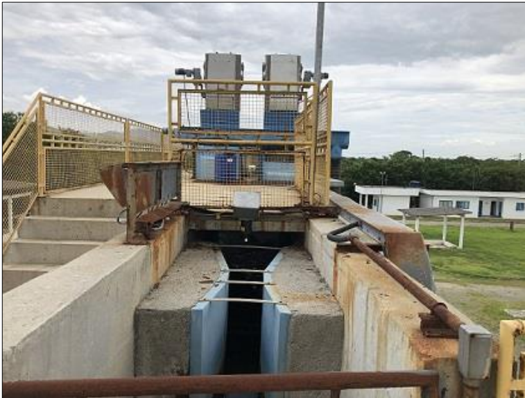
Foto C.4 - Vista do Tratamento Preliminar e Calha Parshall.
