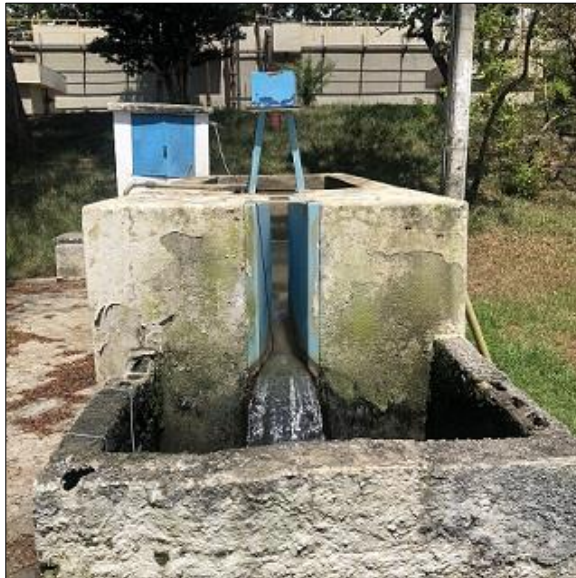
Foto B.10 - Medidor de Vazão Tipo Calha Parshall (Esgoto Tratado).
