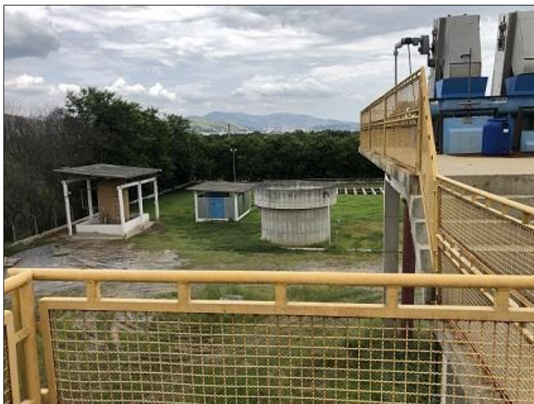
Foto C.16 - Vista do Tanque de Hipoclorito de Sódio e Tanque de Contato ao Fundo.
