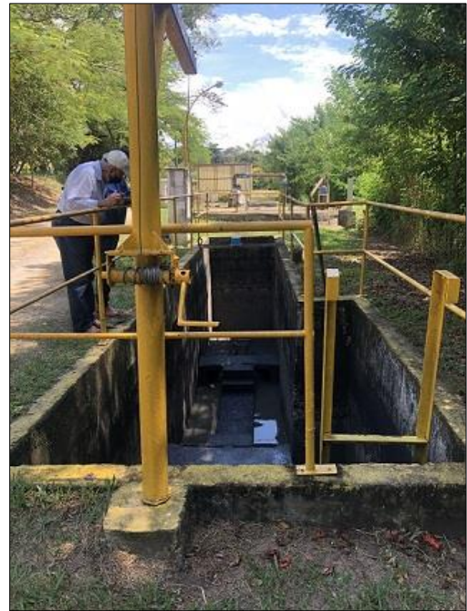
Foto B.2 - Tratamento Preliminar.
